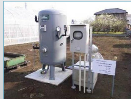
防災兼用農業用井戸と掲示板の設置
