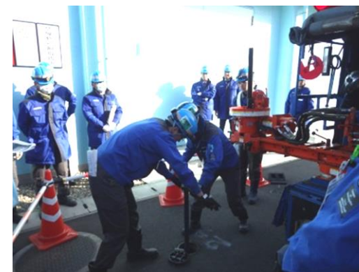
▲ 制水弁開閉車及びバルブ操作により通水を制御
