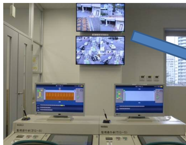
操作室の状況
