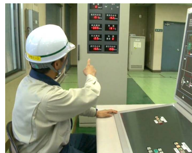
排水機場の操作状況
