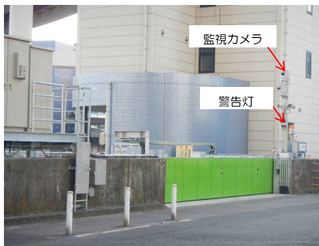
遠隔制御化された陸こうの状況
