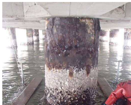
鋼管杭の腐食が進んでいる。 (棧橋(港湾施設)の鋼管杭)
