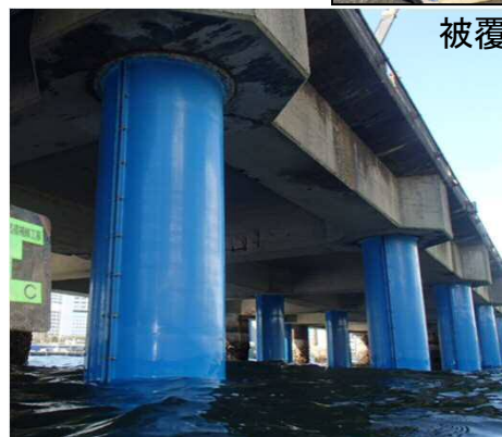
従来型の被覆材料により鋼管杭を覆う。 (30年程度の延命化が図られる)
