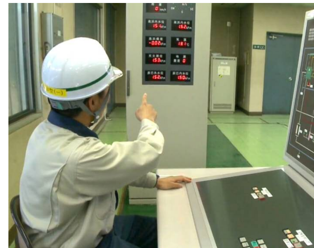
排水機場の操作状況
