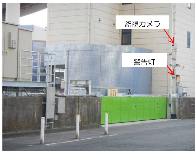
遠隔制御化された陸こうの状況
