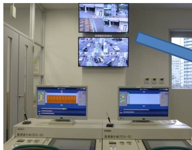
操作室の状況
