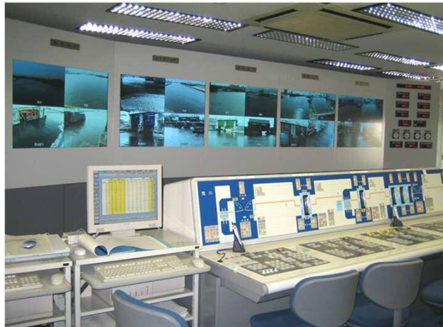
水門の監視モニター
