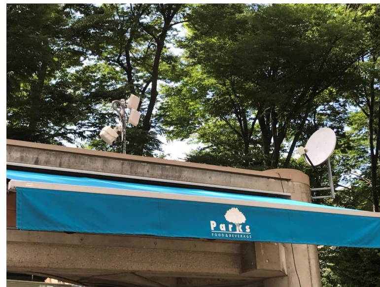
公園内に設置されたWi-Fiアンテナ
