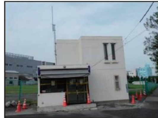
液状化で傾いた建物
